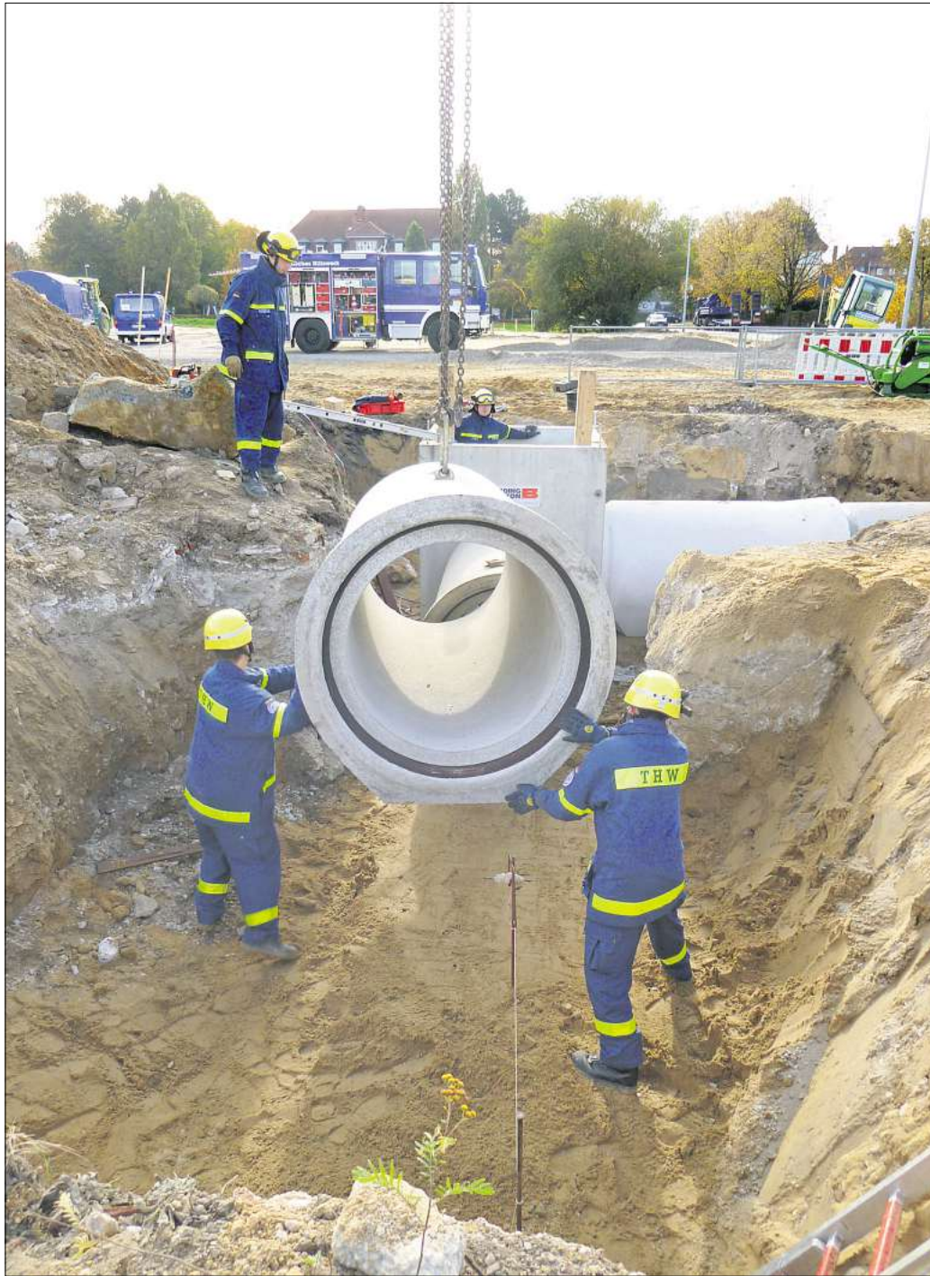
Ehrenamtlicher Einsatz: Die Betonröhren sind Bestandteil der neuen Übungsstrecke des Technischen Hilfswerks, das gegenüber dem Rathaus in Empelde entsteht.
